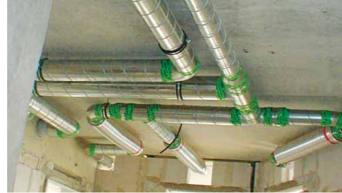
Zu- und Abluftkanäle unter der Decke im Flur.
